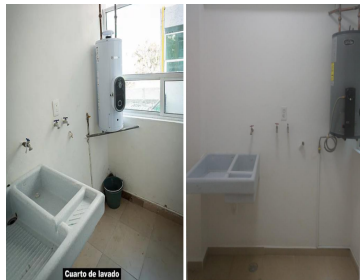
Cuarto de lavado
